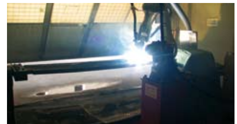
Recubrimiento con equipo automatizado
